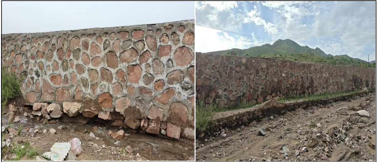
图 4-3 部分堤防掏刷严重
